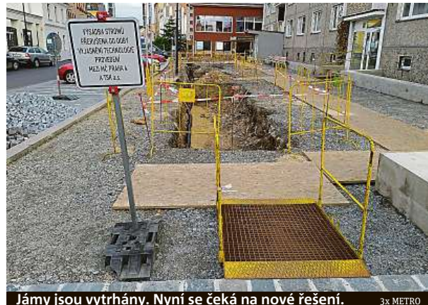
Jámy jsou vytrhány. Nyní se čeká na nové řešení.
