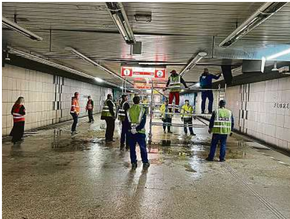
„Nyní odkrýváme podhledy ve stanici, aby voda, která tam nyní je, vytekla, a kontrolujeme protipožární ochranu,“ znělo včera z DPP.
