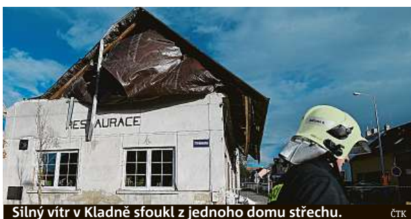
Silný vítr v Kladně sfoukl z jednoho domu střechu. ČTK
