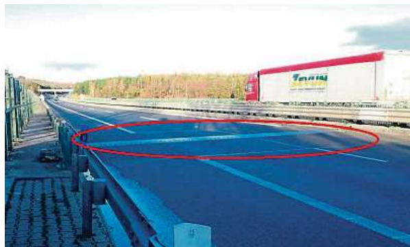
Dálniční most u Voznice těsně před začátkem stávající rekonstrukce. Místní hup řidičům nepříjemně připomínal retardér. ŘSD ČR
