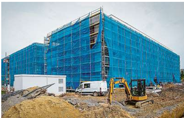
Cenu stavebních bytových projektů výrazně ovlivňuje nejen délka povolování, ale i ceny materiálů a stavebních prací. MAFRA
