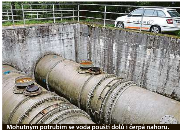
Mohutným potrubím se voda pouští dolů i čerpá nahoru.
