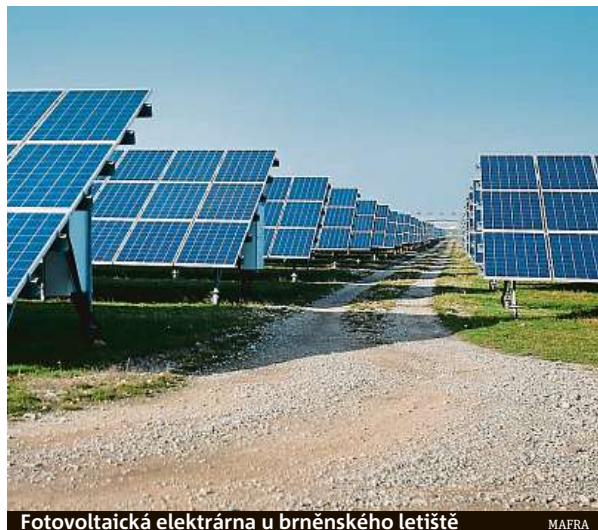
Fotovoltaická elektrárna u brněnského letiště
