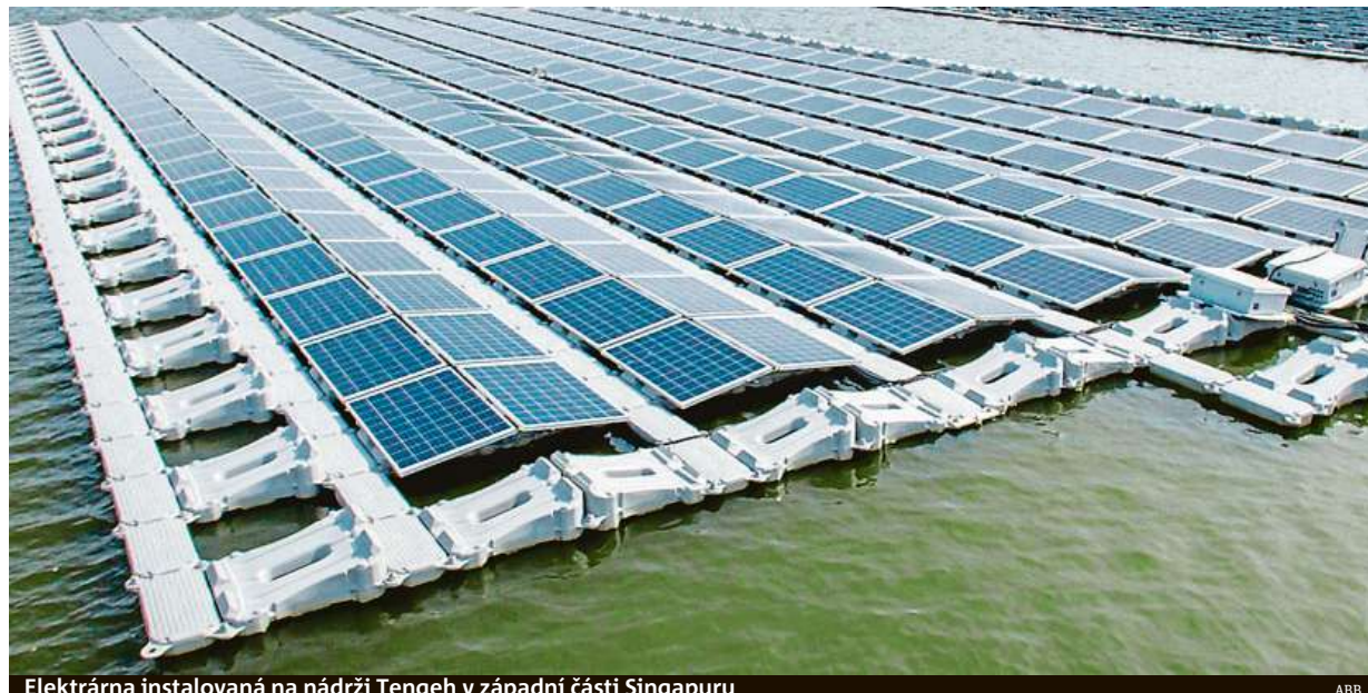
Elektrárna instalovaná na nádrži Tengeh v západní části Singapuru
