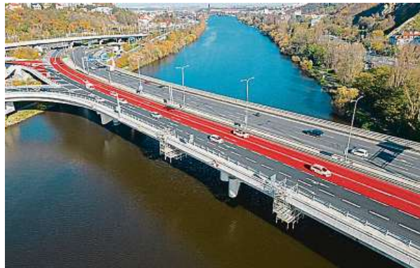
Letošní fáze oprav Barrandovského mostu zahrnuje práce na severní polovině jeho jižní části a na rampě z ulice K Barrandovu. TSK
