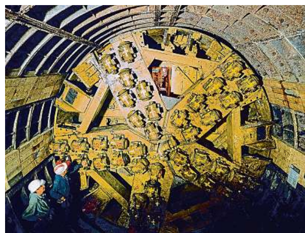
Rok 1975. Mechanizovaný štít TŠČB se zakusuje do pražského podzemí tam, kudy od roku 1978 pojedou vlaky linky A.
