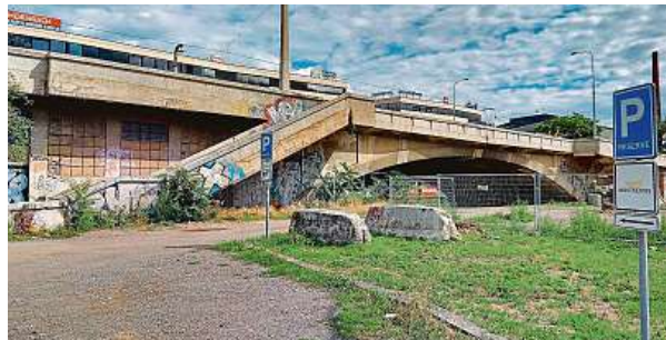
Během jarních měsíců bude zahájena demolice Libeňského soumostí. Konstrukční systém mostu není funkční. 2x TSK
