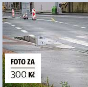
Přechod od ulice K Vodojemu je pro nebezpečný. D. KŘIŠŤANOVÁ
