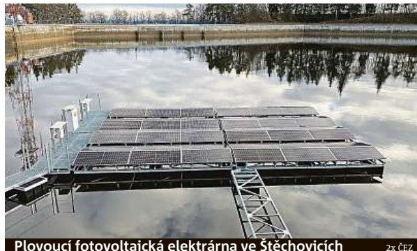
Plovoucí fotovoltaická elektrárna ve Stěchovicích 2x ČEZ
