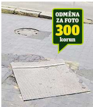
Co se pod poklopem nachází? Nejspíš kabelovod.
