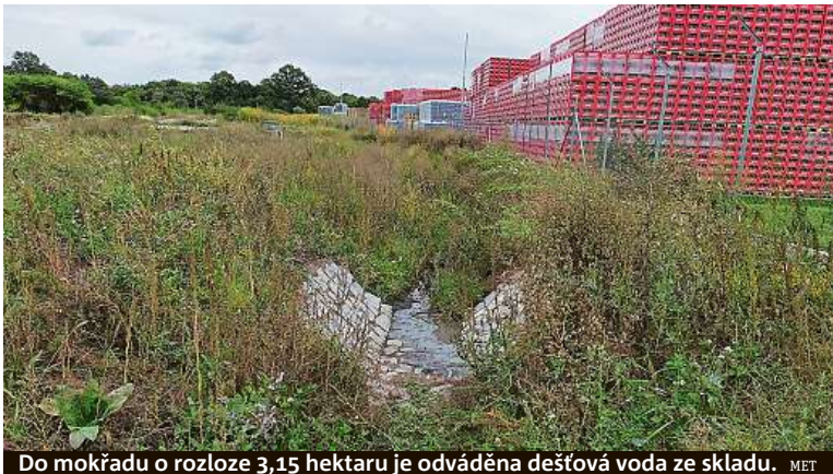
Do mokřadu o rozloze 3,15 hektaru je odváděna dešťová voda ze skladu. MET
