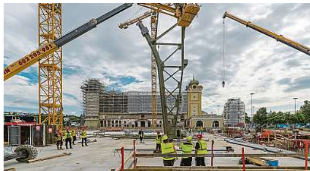
Zdvih prvního pilíře levého křídla unikátní stavby. Ta prochází kompletní rekonstrukcí. VÝSTAVIŠTĚ PRAHA, A. S., JIŘÍ ŠEBEK A METRO
