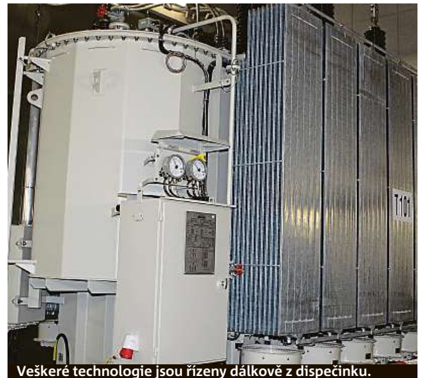
Veškeré technologie jsou řízeny dálkově z dispečinku.
