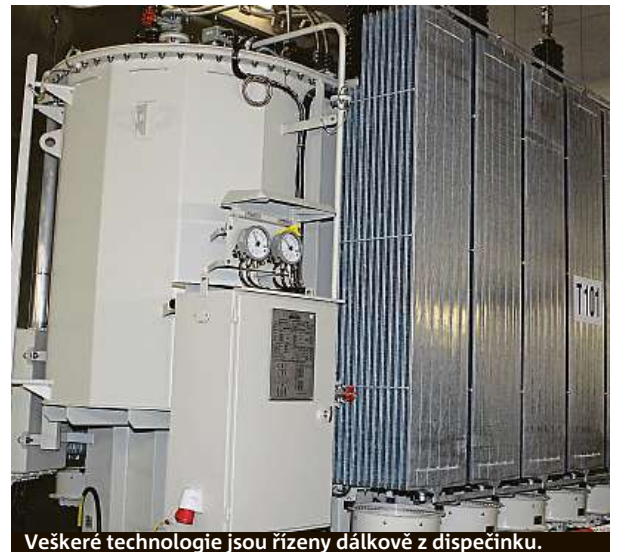
Veškeré technologie jsou řízeny dálkově z dispečinku.
