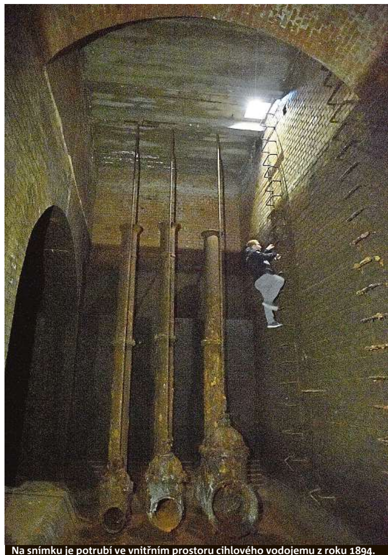
Na snímku je potrubí ve vnitřním prostoru cihlového vodojemu z roku 1894.
