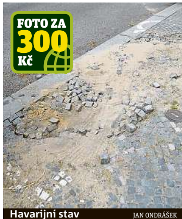
Havarijný stav JAN ONDRÁŠEK
