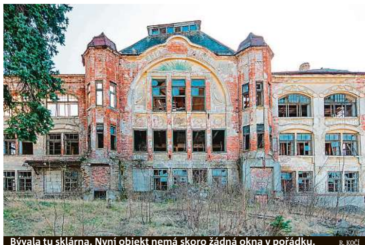
Bývala tu sklárna. Nyní objekt nemá skoro žádná okna v pořádku. R. KOČÍ
