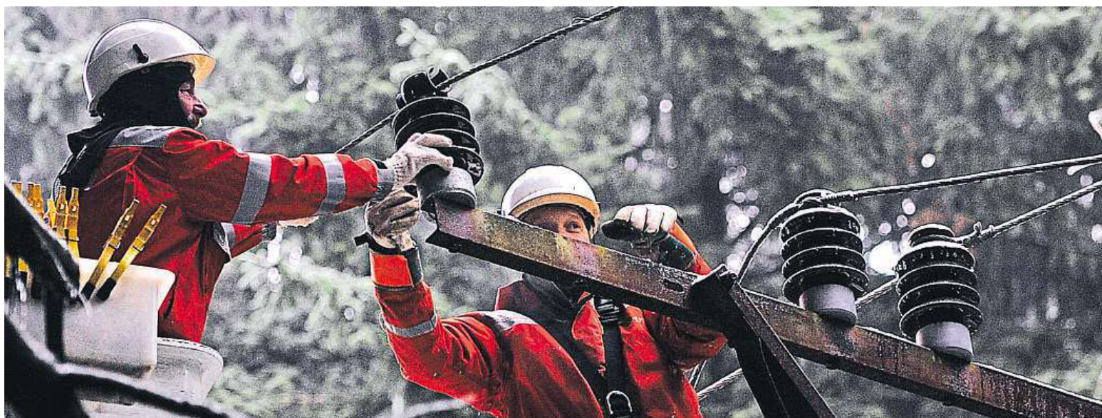
Stovky domácností na Vysočině a střední Moravě se kvůli poruchám elektrického vedení ocitly bez proudu. Na Přerovsku stále trvá kalamiční stav. ČTK
