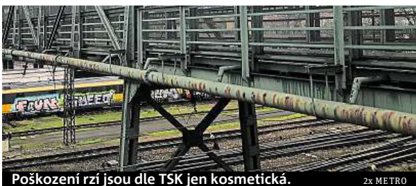
Poškození rzi jsou dle TSK jen kosmetická.
