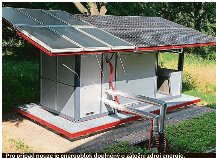
Pro případ nouze je energoblok doplněn o záložní zdroj energie.
