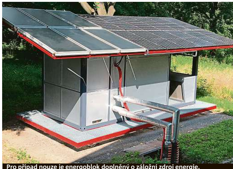
Pro případ nouze je energoblok doplněný o záložní zdroj energie.
