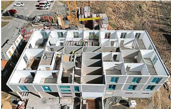
Montáž nadzemního podlaží u typového bytového domu o zastavěné ploše 420 metrů čtverečních je otázkou pěti pracovních dní. 2x ČKAIT
