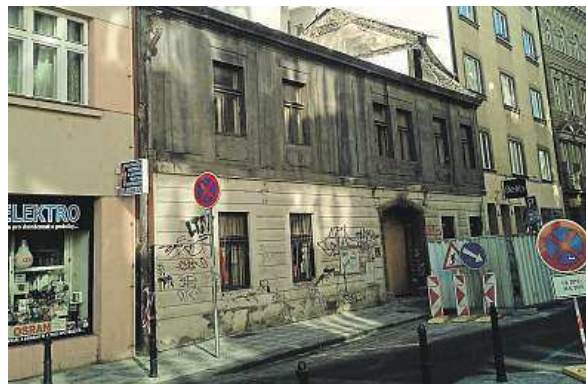
Domu v Soukenické už nějaký čas chybí střecha. METRO
