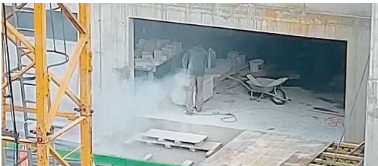
Garáže přilehlého bytového domu se musely opakovaně na náklady spoluvlastníků čistit od prachu a bahna, upozorňuje Ondřej Lubas.
